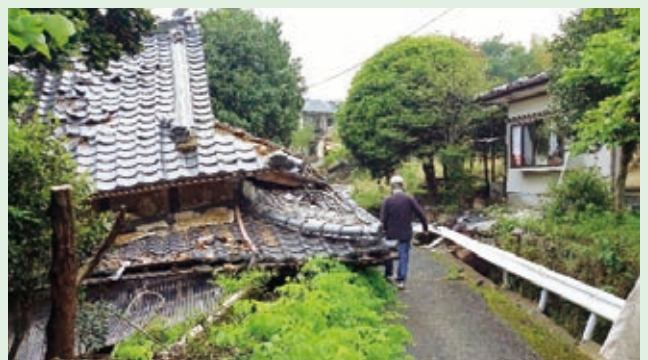
西原村風当地区の被災状況
